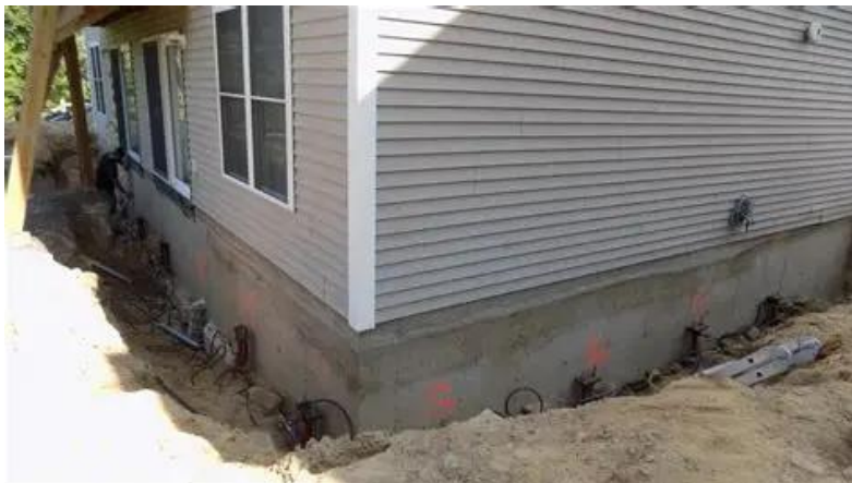
Reclamar Daños por Problemas de Cimentación en Viviendas. (2025, 30 mayo).
